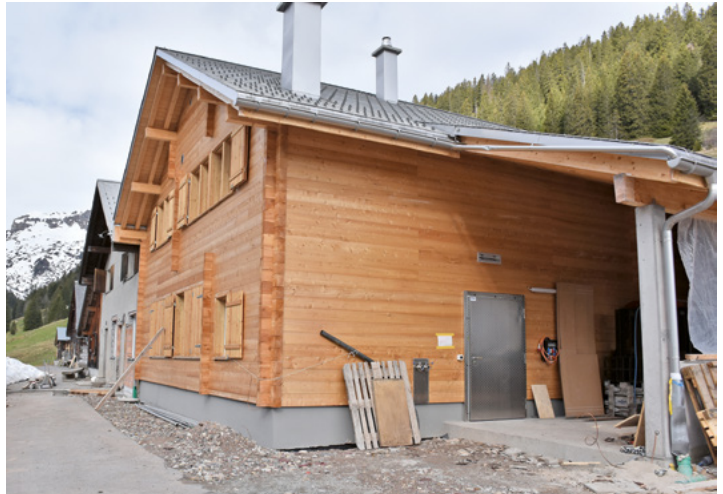
Die neue Käserei auf der Alp Kohlschlag wird im Juni in Betrieb genommen.
